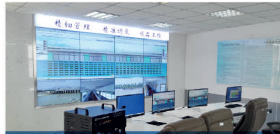
安徽蚌埠闸综合自动化系统 Integrated automation system of Bengbu Sluice, Anhui
