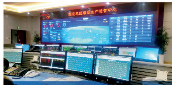
国家电力投资公司江西新能源集控中心监控系统 CSCS of Jiangxi new energy control center, SPIC
